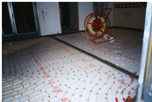
Fußbodenheizung im EG
